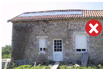
Par leur contraste de couleur et de texture, les panneaux solaires s'intègrent assez mal sur les toitures en tuiles canal.
